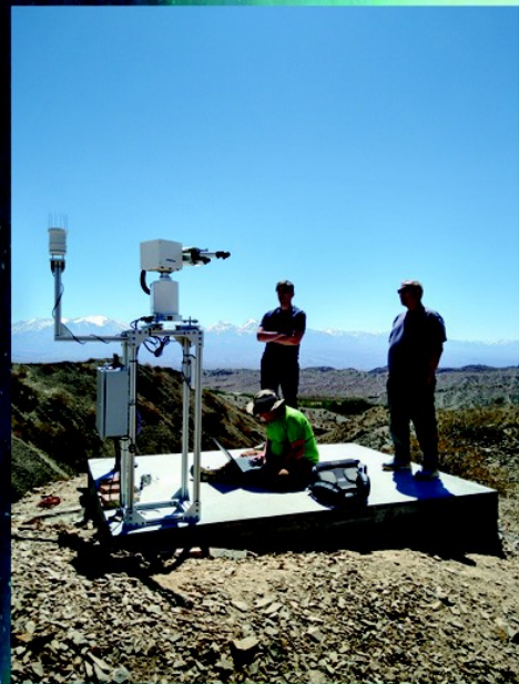
Científicos y Técnicos de EEUU trabajando en la instalación del radiómetro.
